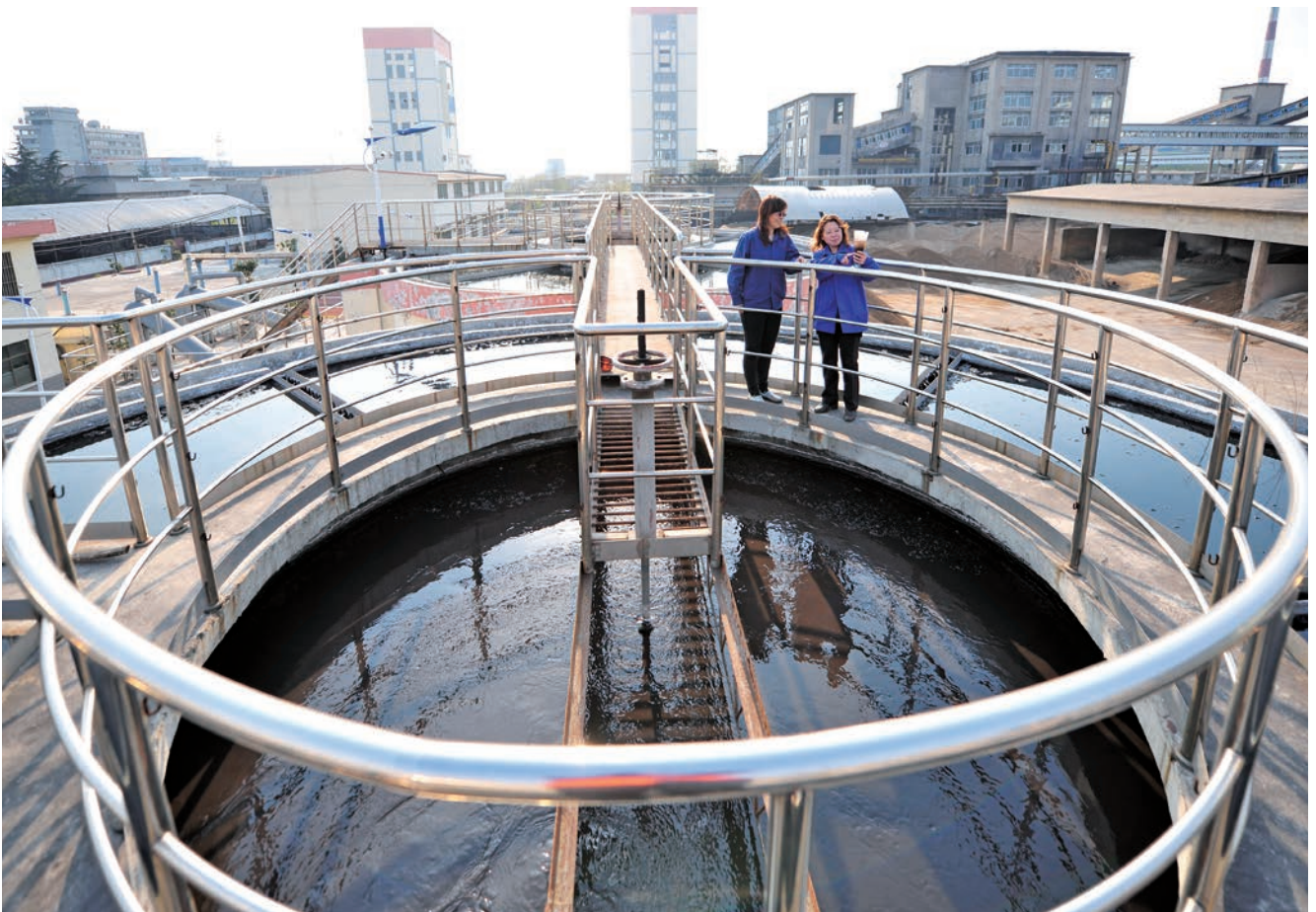
礦井水高效澄清池
