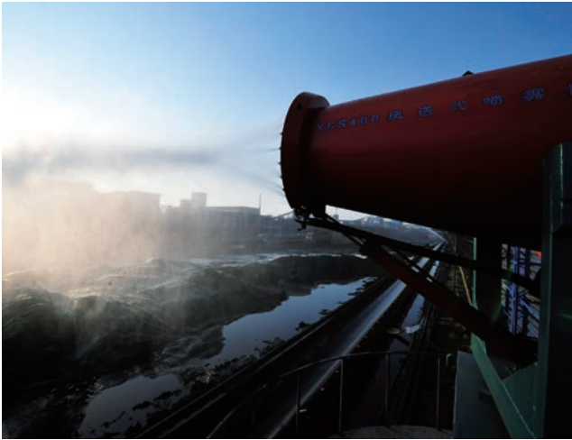
煤場防塵霧炮裝置
