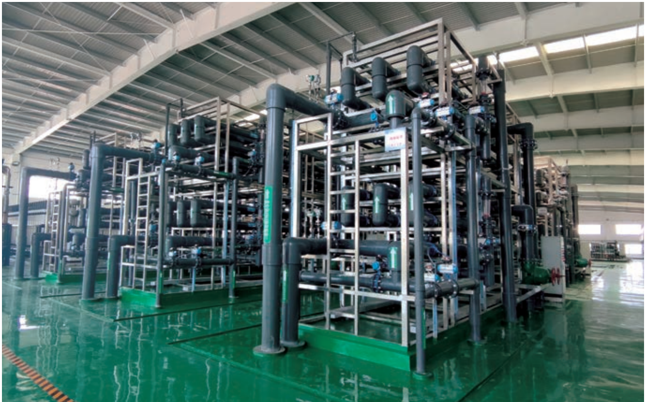
矿井水深度处理系统
