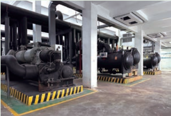
李楼煤业矿井余热综合利用项目设施
