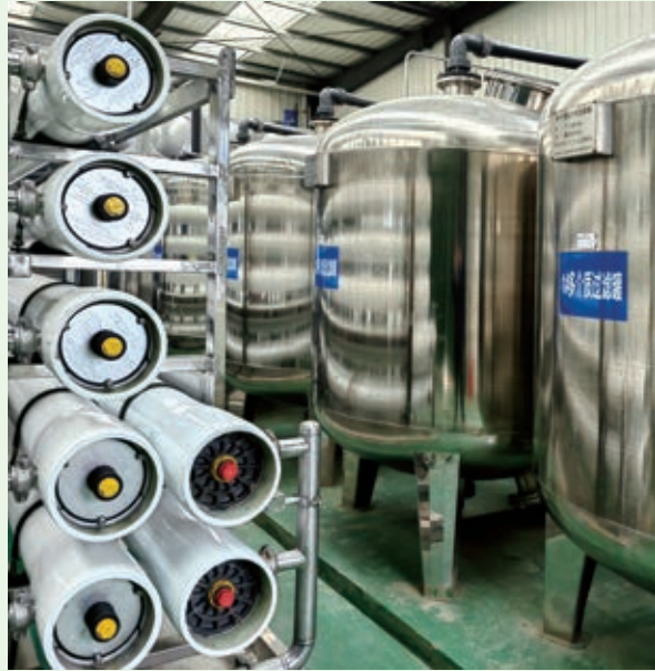
金鸡滩煤矿矿井水深度处理系统
